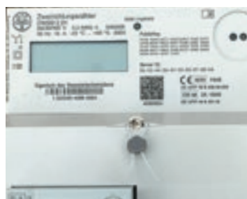
Die Errichtung, Änderungen, Erweiterungen und auch die Demontage müssen dem Netzbetreiber angezeigt werden. Foto: SPREE-PR/Petsch
