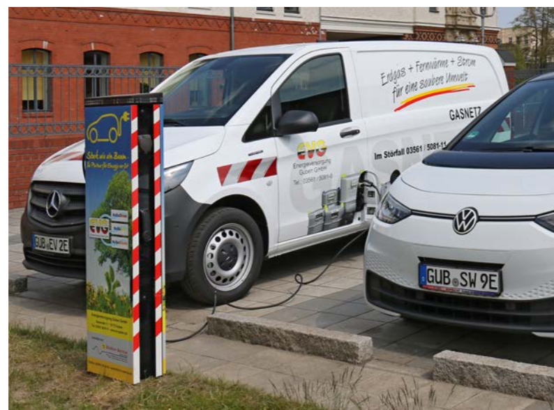
Die Ladesäulen werden noch mit einem SWG-Aufkleber versehen.
